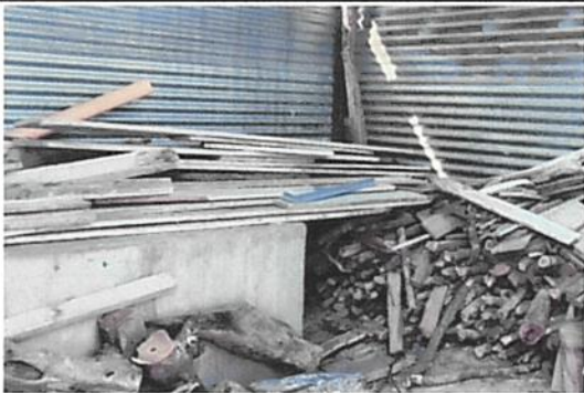
FOTO 5: PILA DE CONCRETO INSERVIBLE
