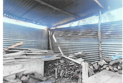
FOTO 4: AREA DE COCINA SIN PAREDES DE BLOCK
